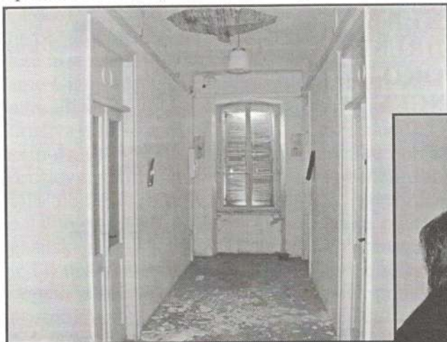
S stropov odpada omet...
